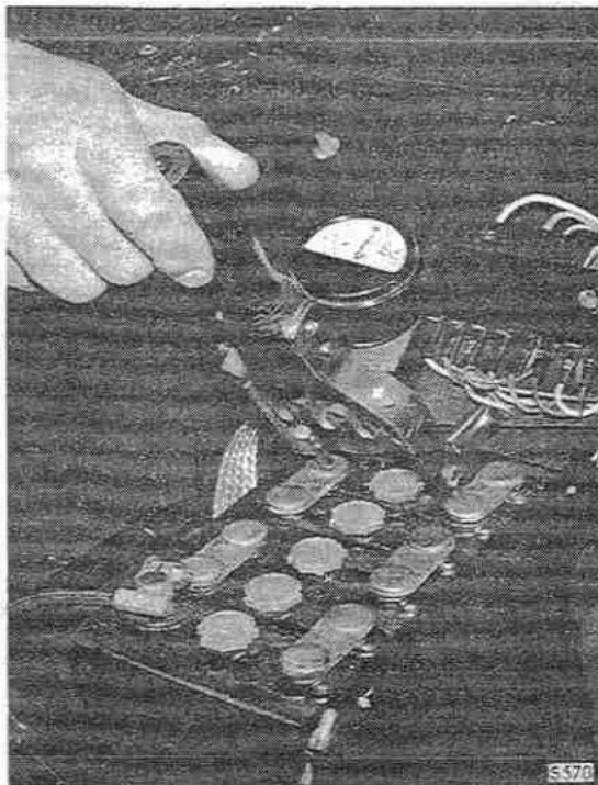
CONTROLE DE BATTERIE AVEC APPAREIL DE CONTROLE D'ÉLÉMENTS
